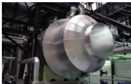
Obr. 5 – Topný výměník zapojený do horkovodní sítě CZT
