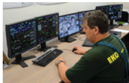
Obr. 6 – Ovládání biobloku z nového velínu
