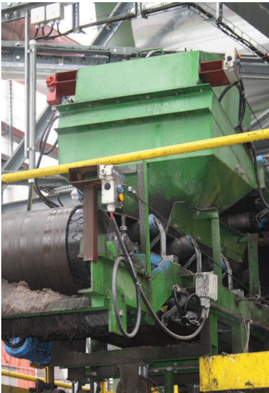
Pohled na technologické části bioelektrárny
