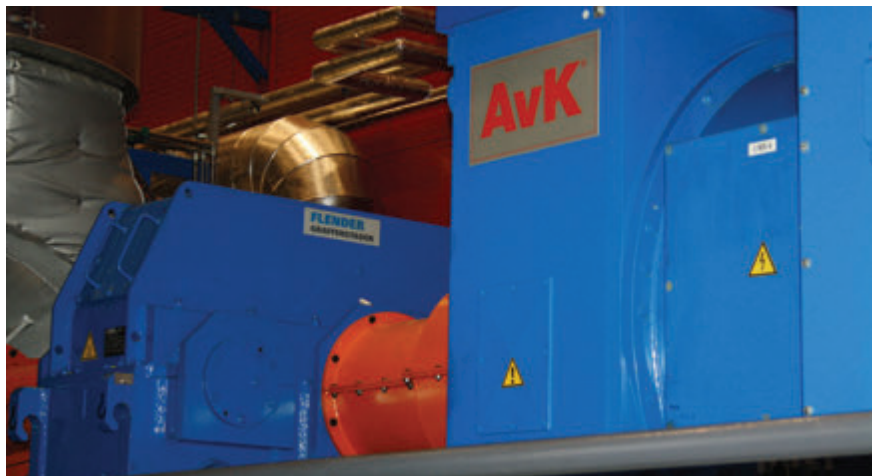
Generátor AvK v kotelně bioelektrárny ve Sviadnově
