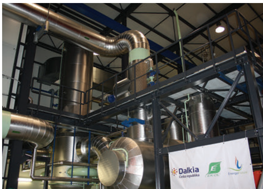
Snímek z kotelny bioelektrárny ve Sviadnově
