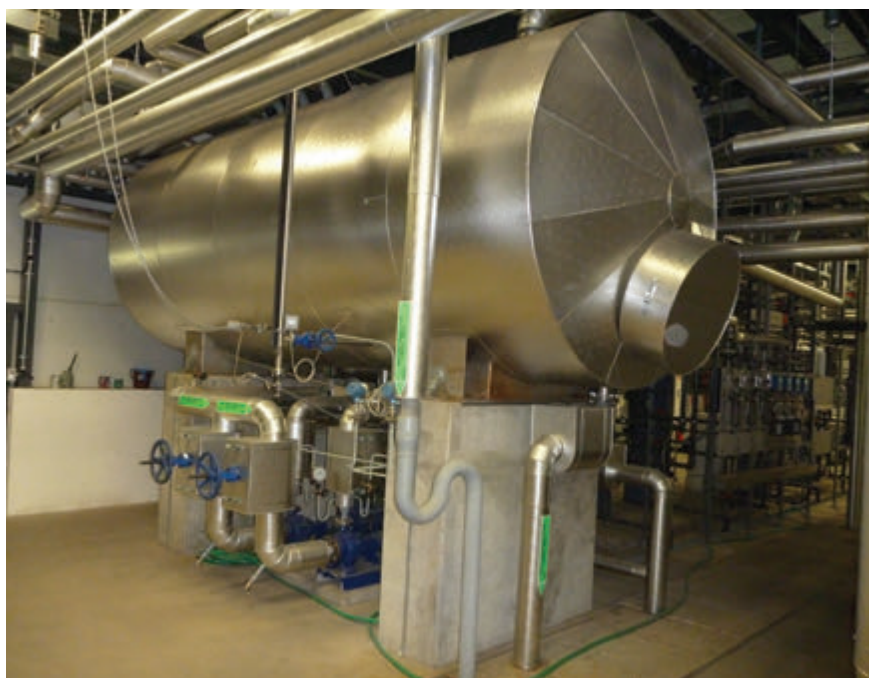
Nádrž sběrného kondenzátu
