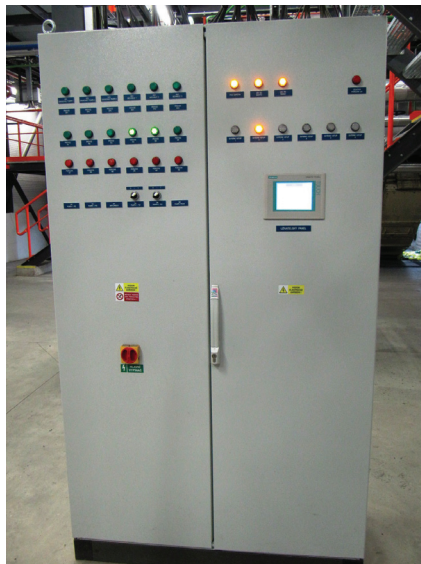
Centrální elektrorozvaděč a nadřazený řídicí a monitorovací systém
