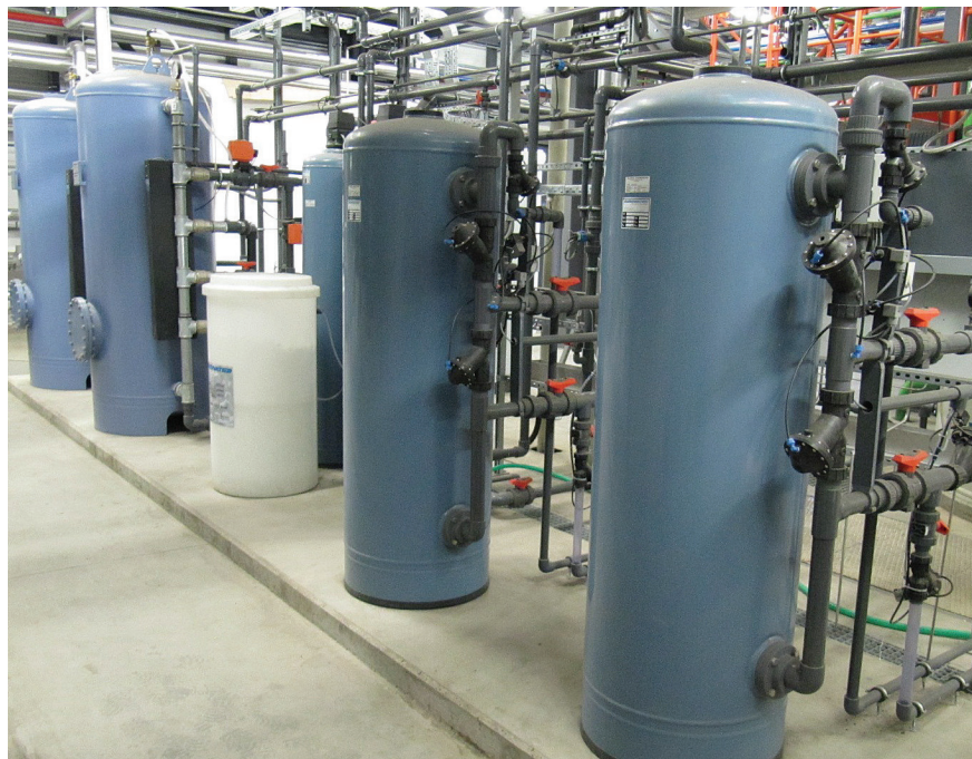
Předúprava vstupní vody
