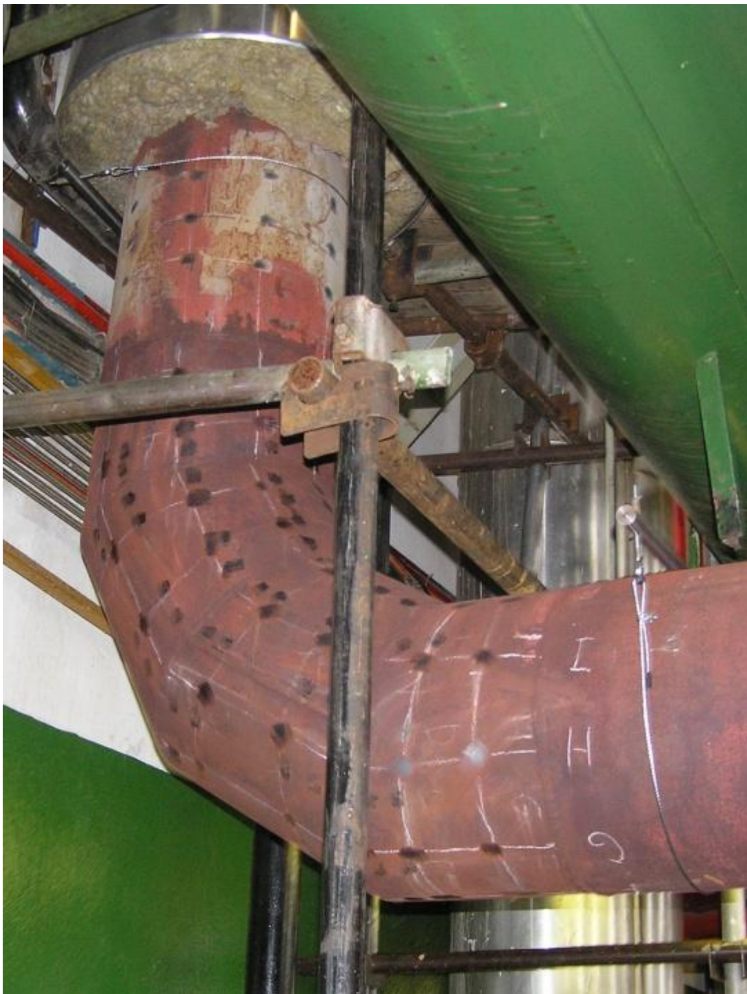
Koleno parovodu (průměr 426 mm)
