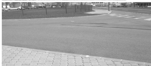
Místo nad potrubím s výskytem anomálního signálu
