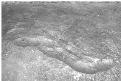
Mechanický defekt v místě anomálie
