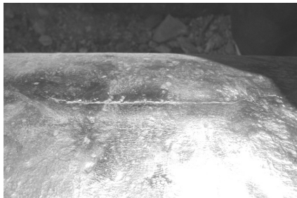
Podélný defekt na potrubí – trhlina
