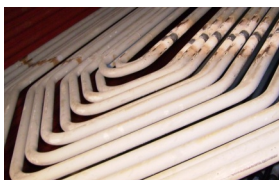
Obr. 14 Vnitřní kotlové trubky Fig. 14 Inner boiler pipes
