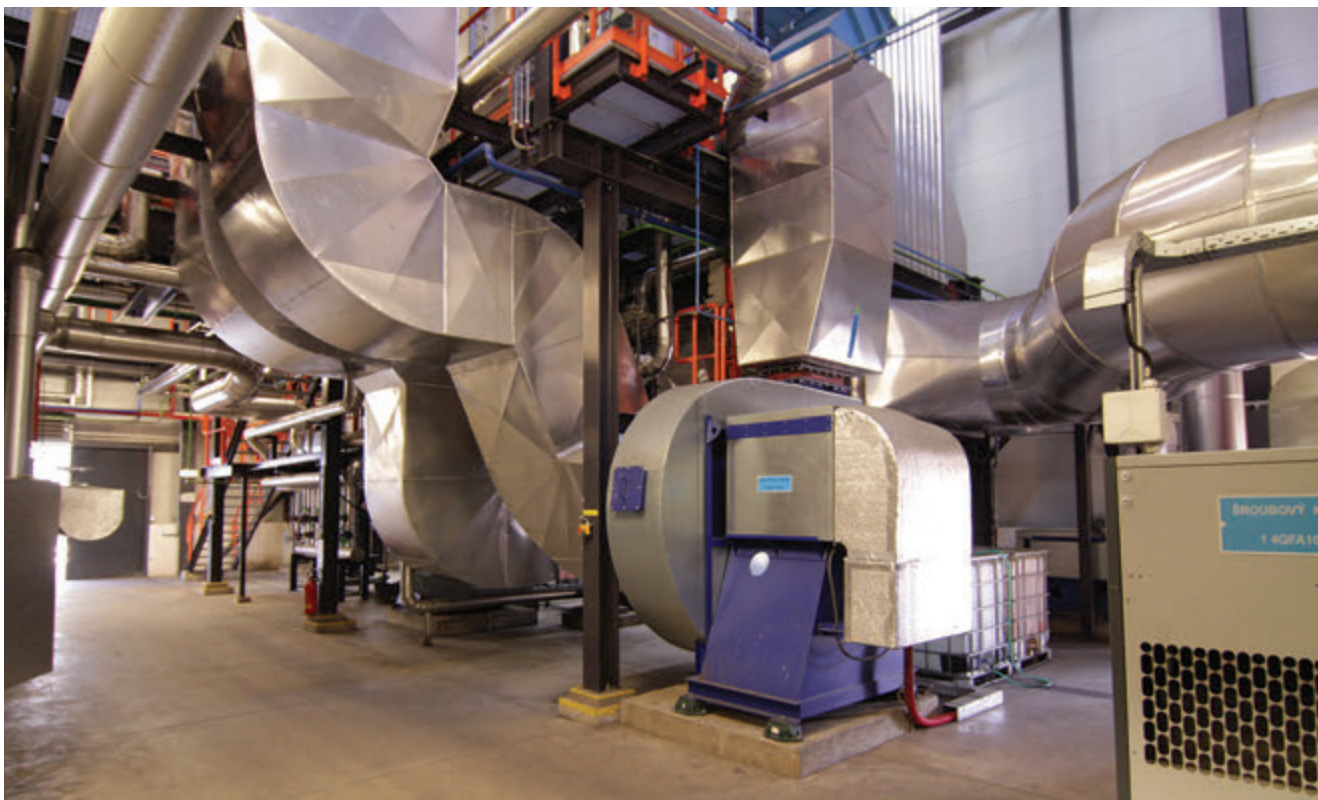
Podkotlí s ventilátory primárního a sekundárního vzduchu
