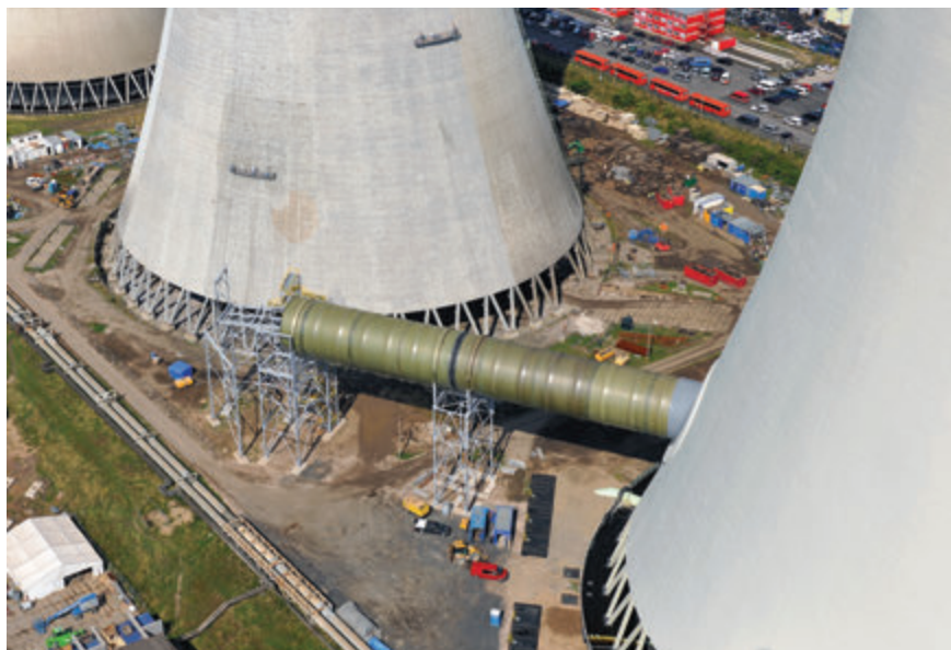
Kouřovod čistých spalin v chladicí věži č. 3
