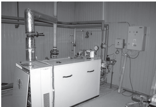
Kogenerační jednotka TEDOM MT 22 pro spalování energoplynu
