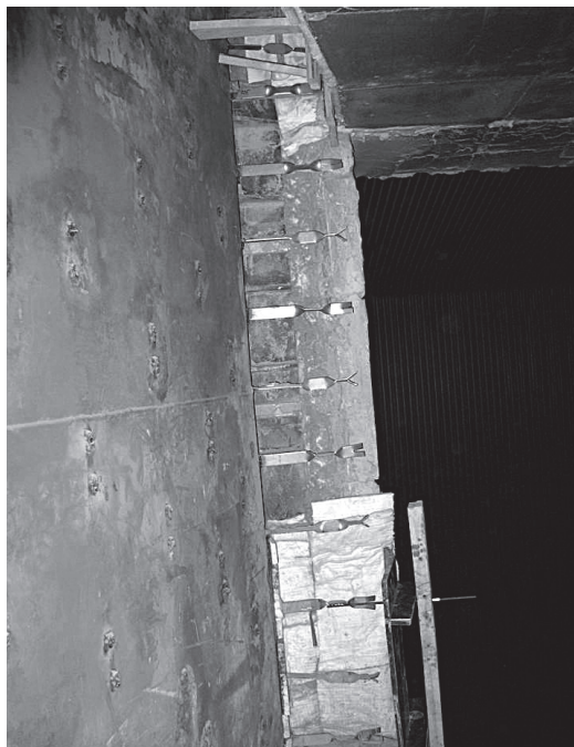
Pohled na poškozenou vyzdívku Chladiče popelovin
