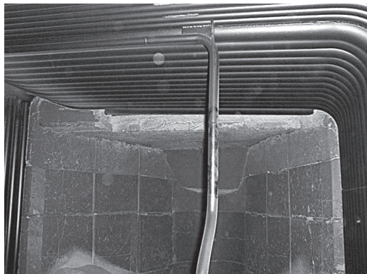
Pohled na poškozenou vyzdívku Chladiče popelovin
