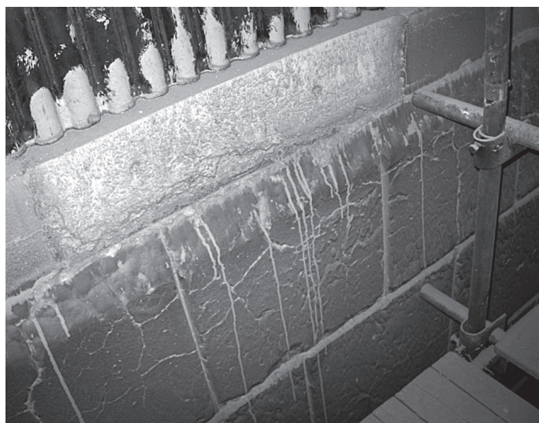
Pohled na poškozenou část vyzdívek Spalovací komory
