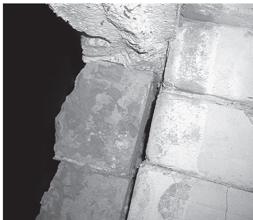
Detail poškozené vyzdívky válcové části Cyklonu
