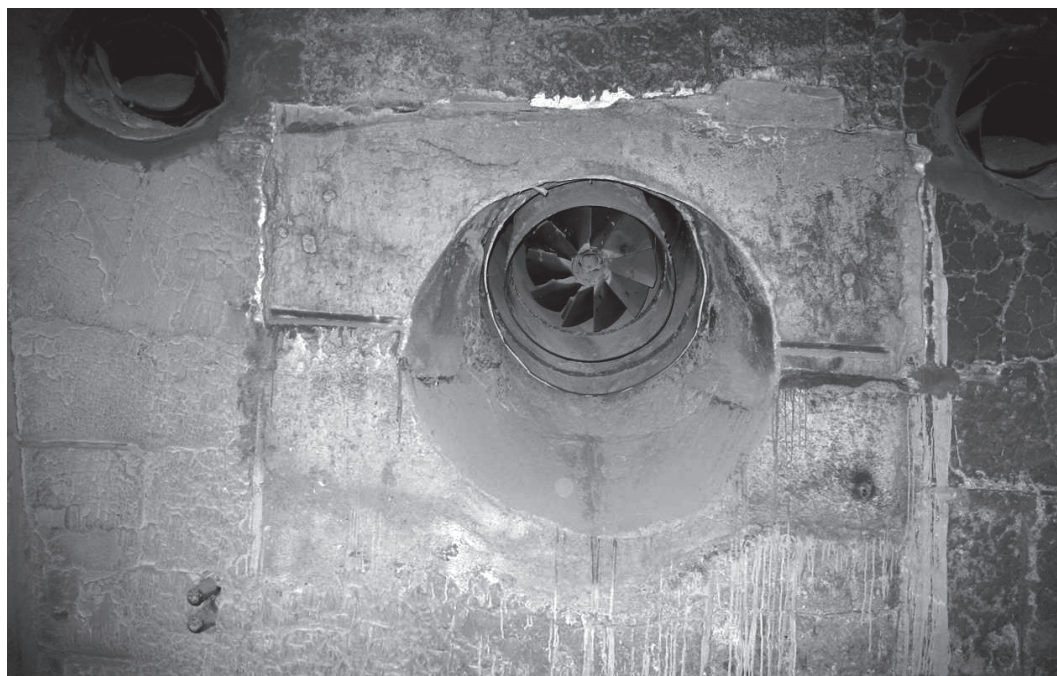
Zaústění hořáku ve spalovací komoře
